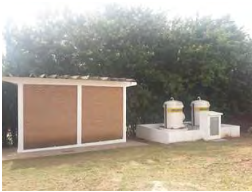
Figura 21 – Estação de tratamento de esgoto
