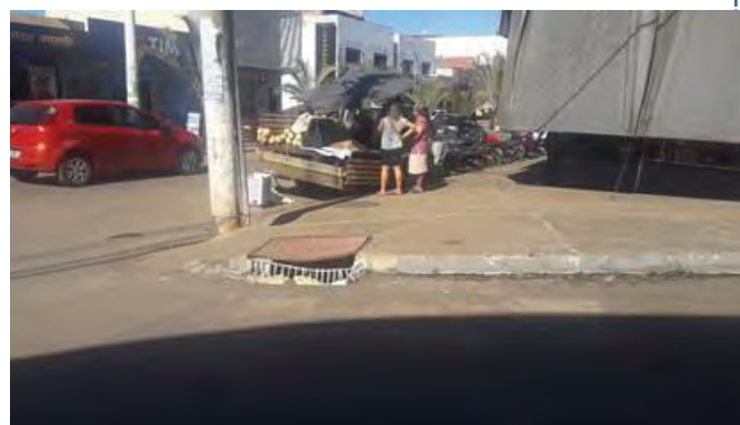
Figura 50 – drenagem de água pluvial.
