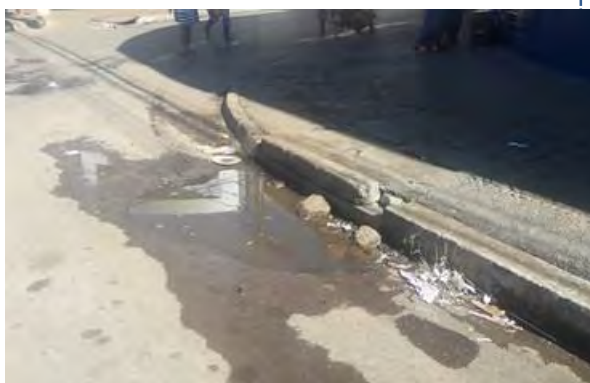
Figura 49 – drenagem de água pluvial.
