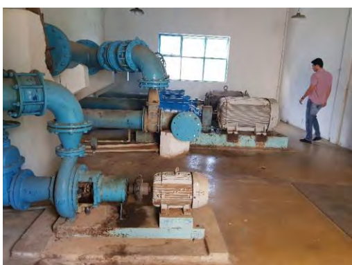
Figura 45 – Estação de tratamento de esgoto.
