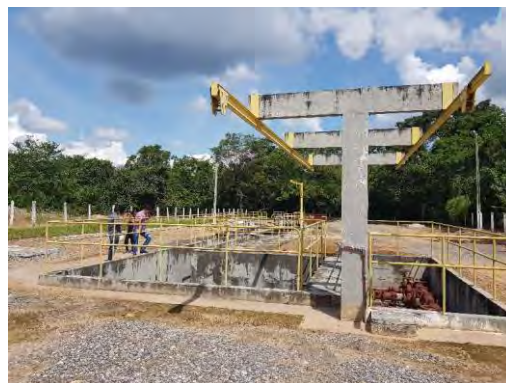
Figura 42 – Estação de tratamento de esgoto.
