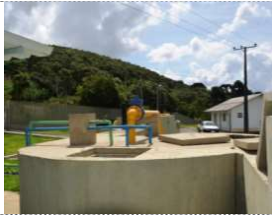
Figura 9. Estação de Tratamento de Esgoto. Tratamento Preliminar. Fonte IU.
