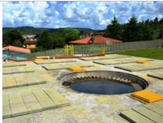
Figura 11. Estação de Tratamento de Esgotos. Tratamento Secundário. Fonte IU.
