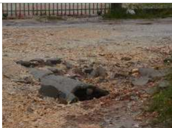
Figura 28. Boca de Lobo assoreada. Fonte IU.
